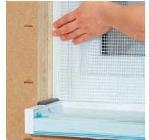
ウインドプロファイルの施工 (サッシがダキ納まりの場合)
